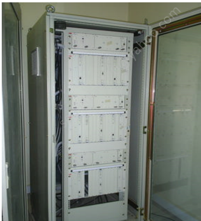
نمای کلی کابینت PLC
