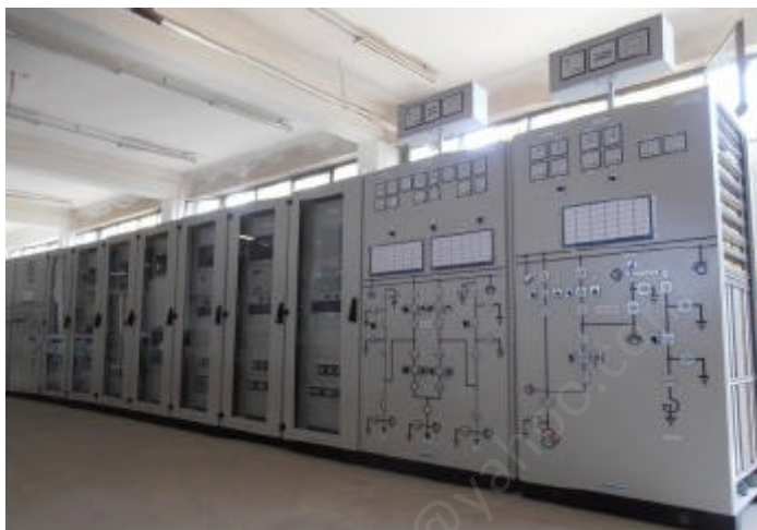
نمای یک تابلوی فرمان
