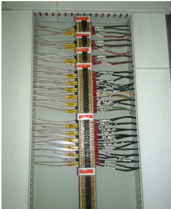
ترمینال های تابلو
