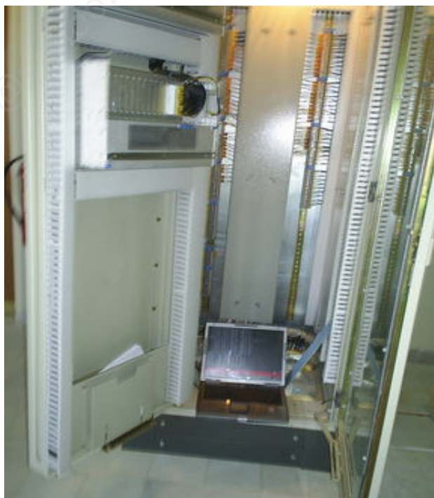
نمای داخلی RTU )
