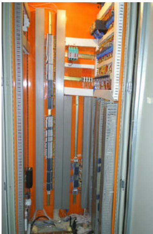
نمونه هایی از تابلو HVI (متمرکز در یک تابلو) در
