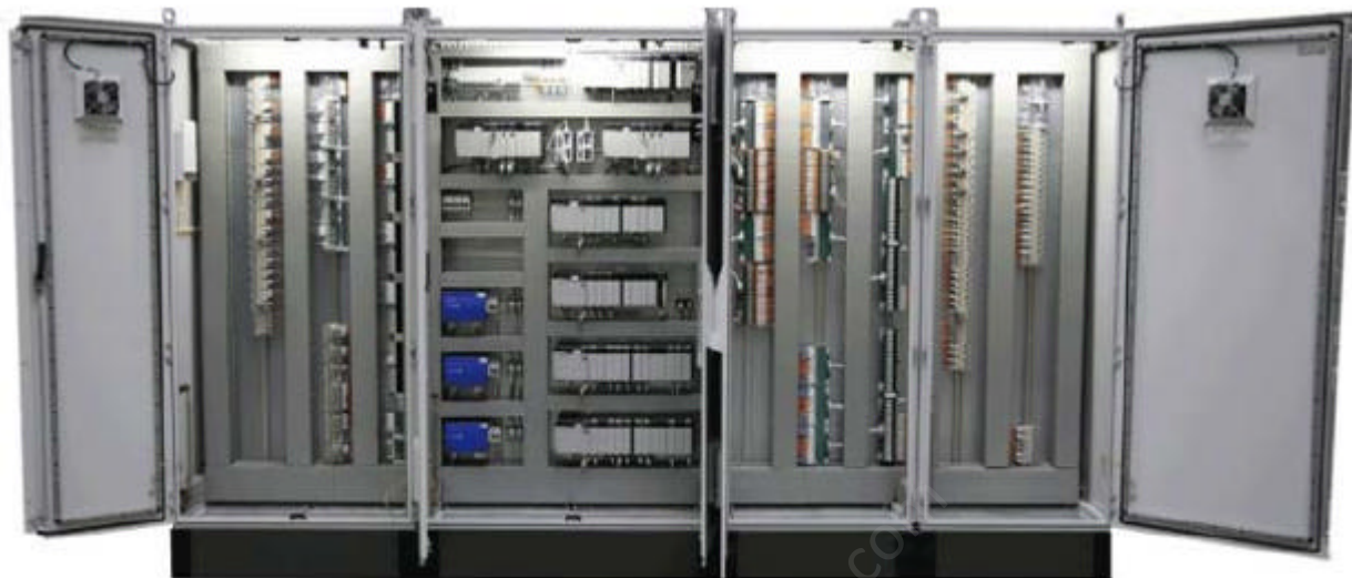
تابلو مارشالینگ (Marshalling Panel)
