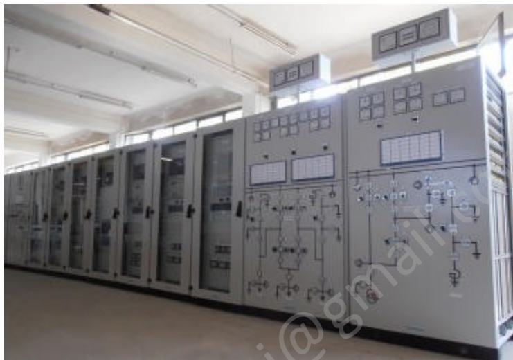
نمای یک تابلوی فرمان
