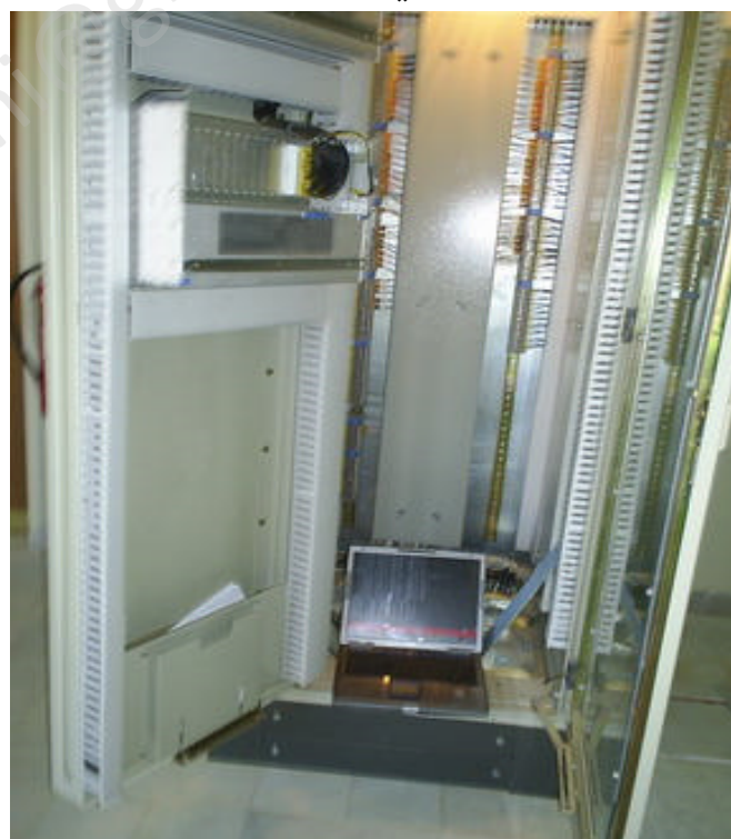
( RTU نمای داخلی )
