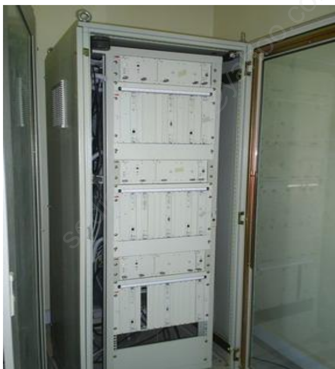
نمای کلی کابینت PLC
