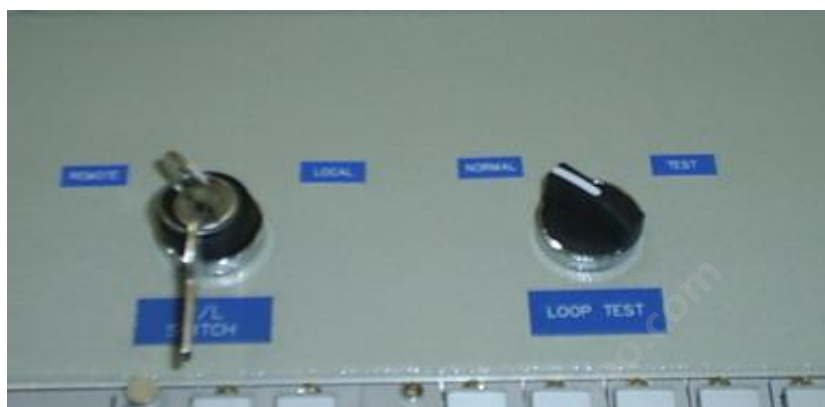
کلیدهای Remote/Local و Loop Test
