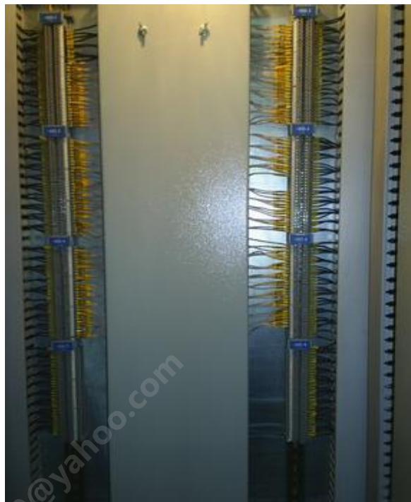
ترمینال‌های داخلی RTU
