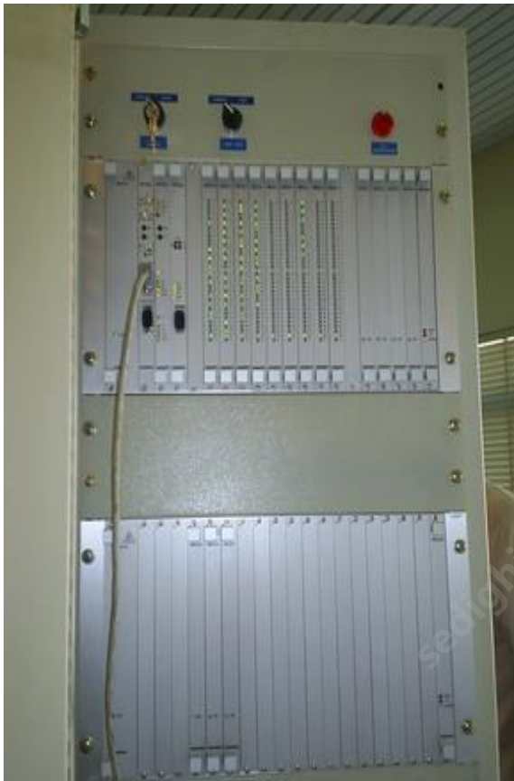
کارت‌های RTU ایستگاه
