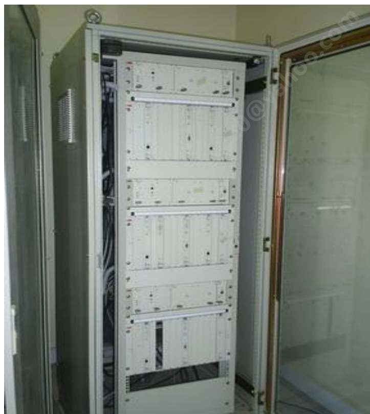
نمای کلی کابینت PLC ایستگاه
